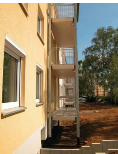
Obr. 14 Při rekonstrukcích se uplatňují předsazené samonosné konstrukce balkónů, lodžií atd. Umožňují dosáhnout spojitěho zateplení bez tepelných mostů. Je pouze nutné ponechat dostatek místa pro umístění izolace mezi konstrukci lodžie nebo balkónu a obvodovou stěnu.
