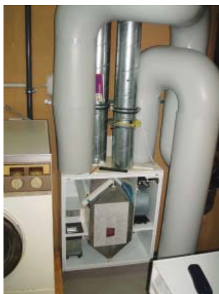
Obr. 11 Ukázka čistého provedení pomocí pevných rozvodů, které si vyžaduje i návrh trasování. Chladné potrubí je izolováno parotěsnou izolací, aby nedocházelo na jeho povrchu ke kondenzaci vlhkosti.
